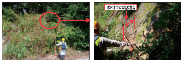
亀裂のある吹付工
