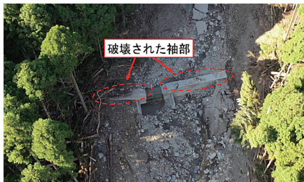
図3 破壊された治山谷止工
