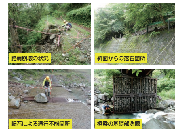
図6 アクセス道路の損傷状況
