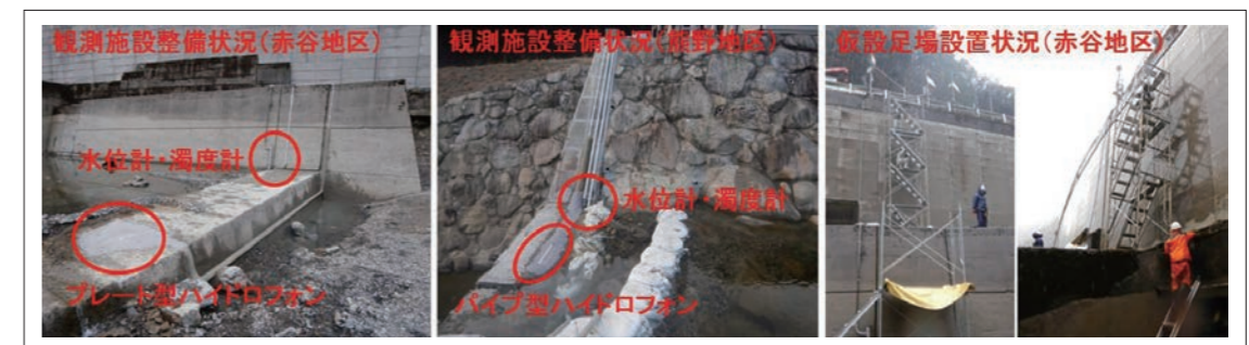
図1 流砂観測施設の整備状況
