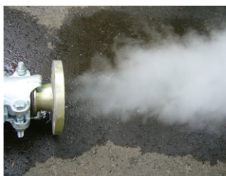
水蒸気の吐出状況
